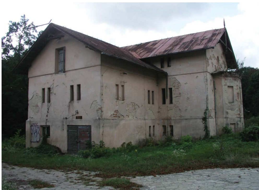
Ryc. 12. Zdjęcie elewacji analizowanego budynku (stary spichlerz, zespół pałacowo-parkowy w Międzyrzecu Podlaskim)
