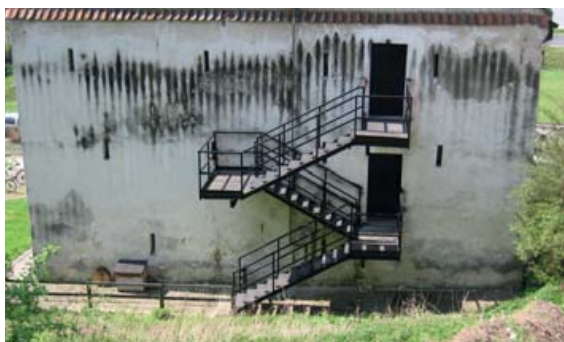
Rys. 9. Wynik działania wody, soli i korozji biologicznej
