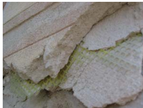
Rys. 8. Uszkodzenia tynków wapiennych na siatce – elewacja frontowa
