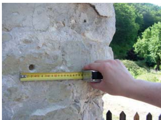
Rys. 11. Miejsce wykazujące największe zawilgocenie i zasolenie muru (nr 2) na elewacji północno – zachodniej (Rys. 7)
