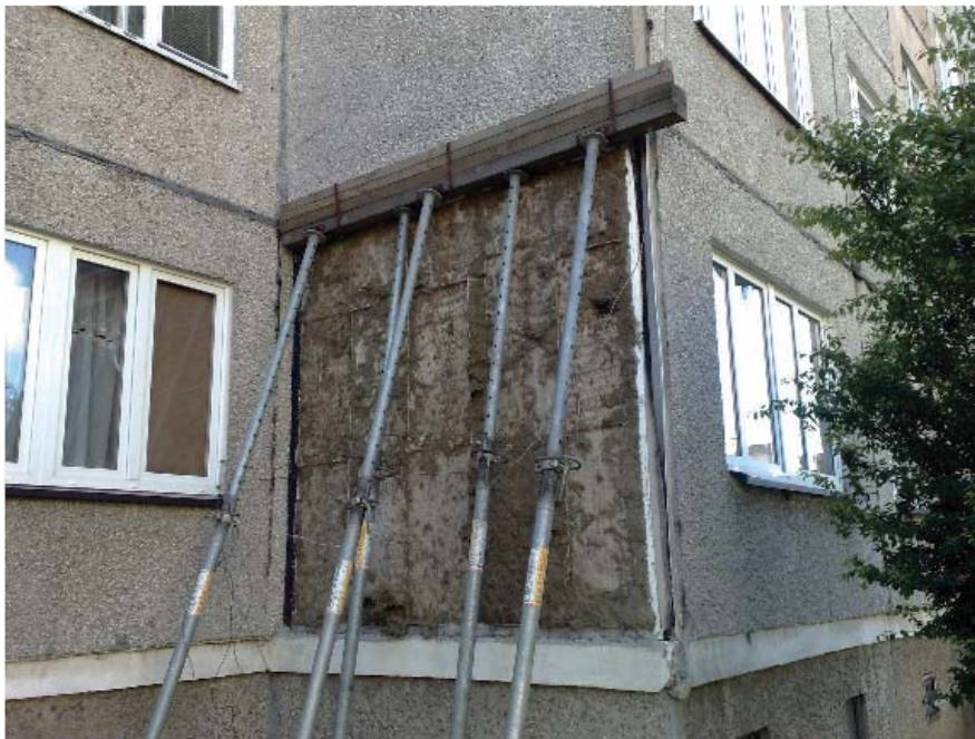
Rys. 6. Osunięcie płyty na skutek braku dostatecznych wzmocnień ( www.thelinked.nspace.pl )
